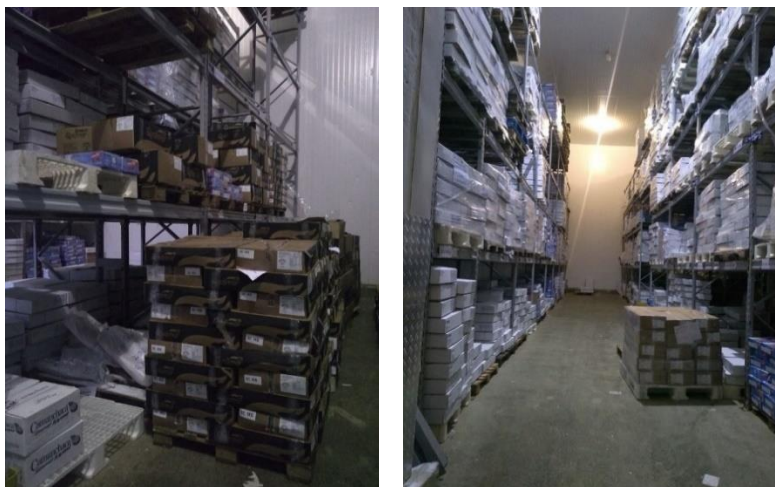
Figura 23 - Câmara de armazenamento sob temperaturas abaixo de -18^{\circ}\text{C} na Unidade Beneficiadora de Pescados Qualimar. Fonte: Arquivo Pessoal, 2018.
