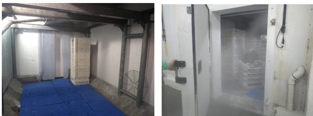
Figura 19 - Túnel de congelamento vazio e com os filés embandejados para serem congelados na Unidade Beneficiadora de Pescados Qualimar. Fonte: Arquivo pessoal, 2018.
