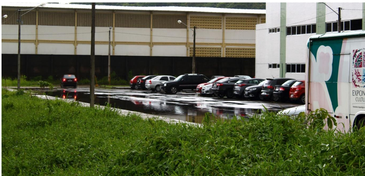
Figura 5. Área inundada do estacionamento do Edifício Vasconcelos Sobrinho.
