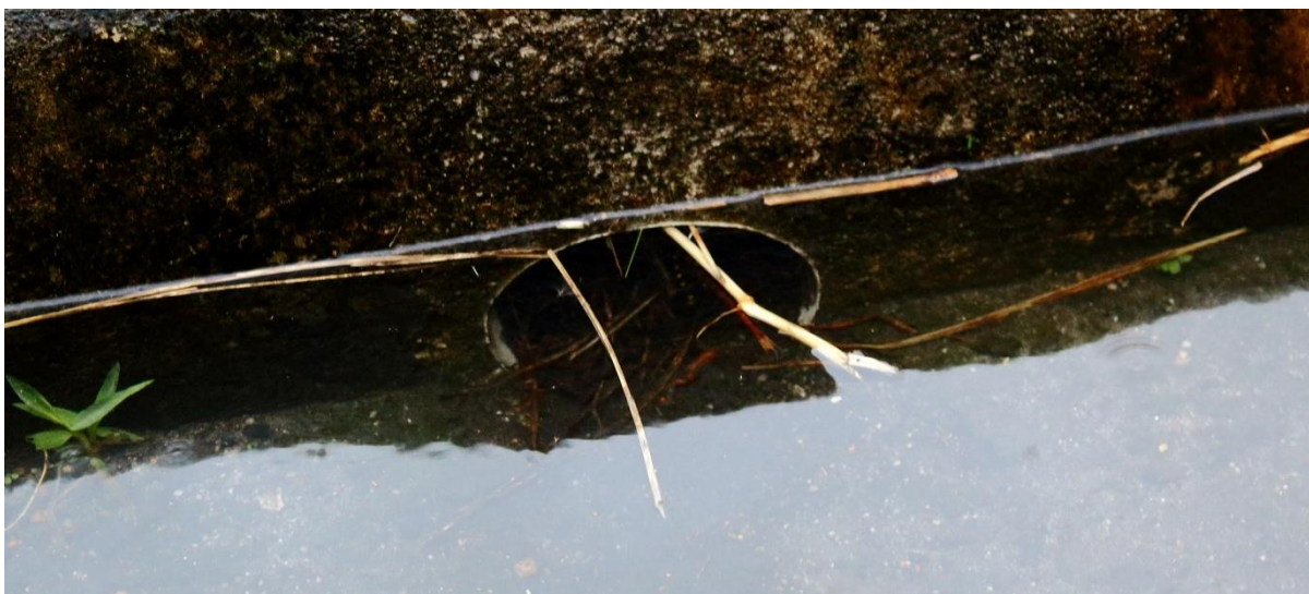
Figura 7. Estrutura obstruída e inundada na área do estacionamento do Edifício Vasconcelos Sobrinho.
