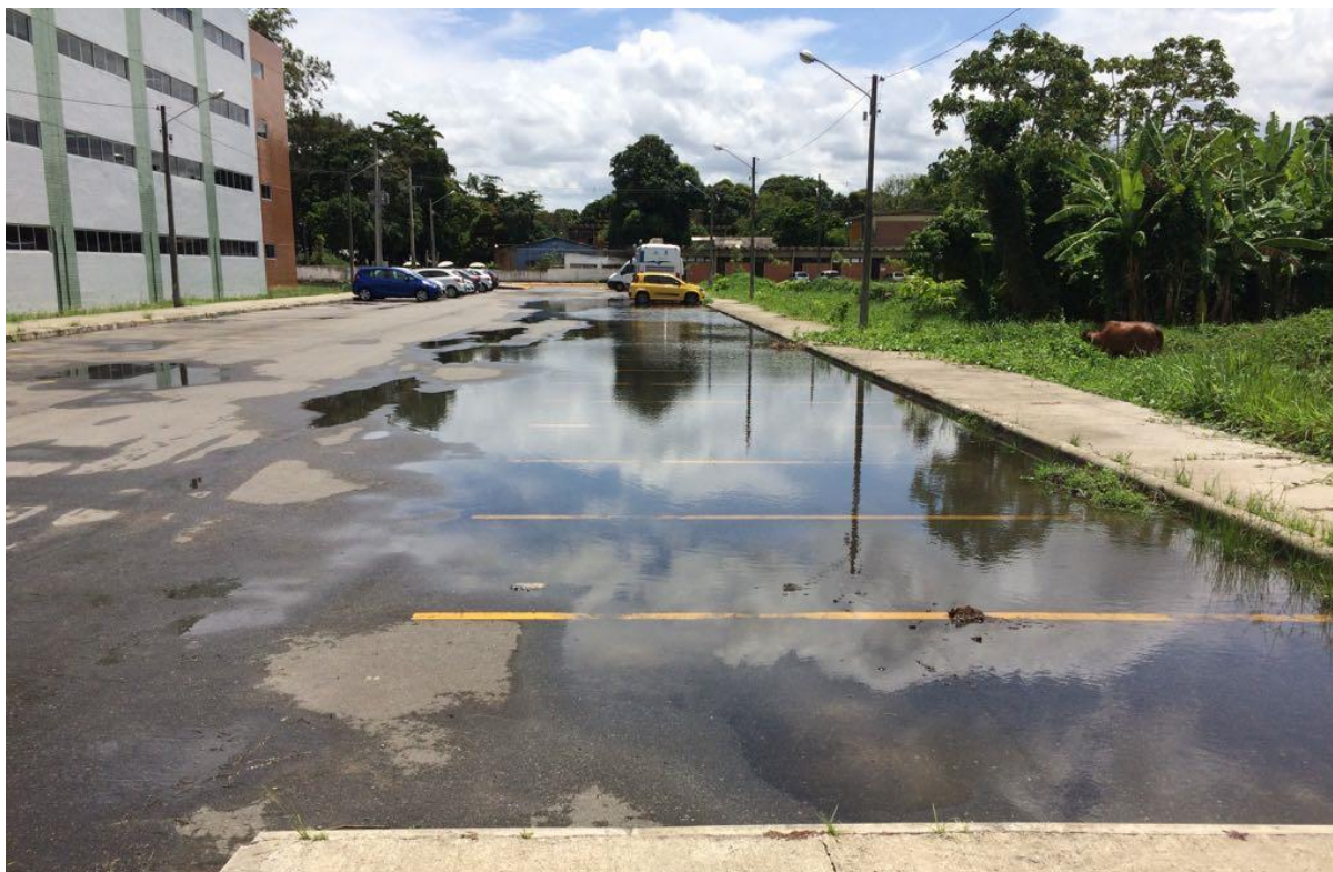
Figura 4. Área inundada do estacionamento do Edifício Vasconcelos Sobrinho.
