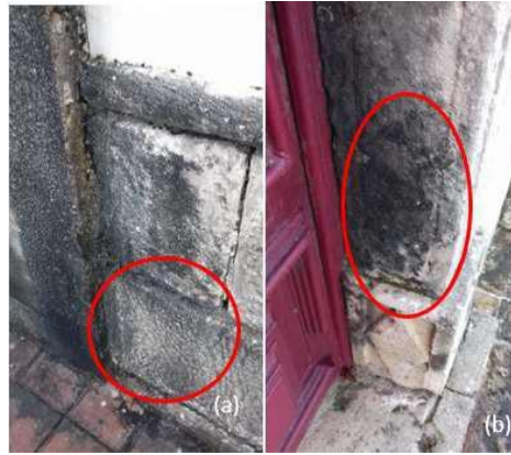
Figura 9: Patologias em bens pétreos no frontispício da Igreja de Nossa Senhora da Piedade: (a) alveolização e crosta negra; (b) degradação diferenciada e mofo.
