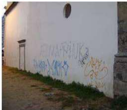
Figura 8: Fachada lateral da Igreja de Nossa senhora da Piedade sobre atos de vandalismo.
