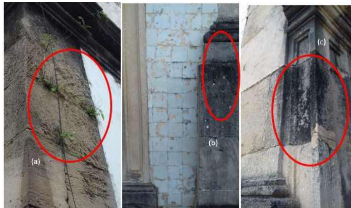
Figura 4- manifestações patológicas nos arenitos da fachada da Igreja de Nossa Senhora dos Prazeres: (a) alveolização da rocha com presença de vegetação entre um bloco e outro; (b) Crosta negra; (c) presença de mofo.
