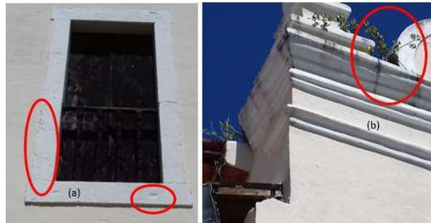
Figura 15: (a) desgaste superficial da rocha; (b) vegetação e sujidades nas cornijas.
