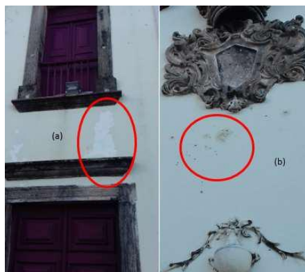
Figura 11: (a) descascamento de pintura; (b) Destacamento pontual do reboco.
