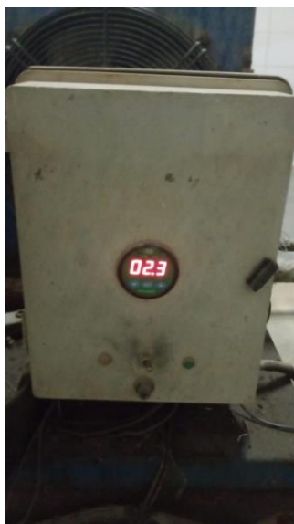
Figura 2. Verificação do termostato de tanque de refrigeração.
