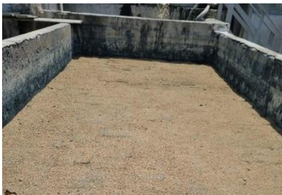
Figura 7: Filtro de areia da lavanderia parceira.
