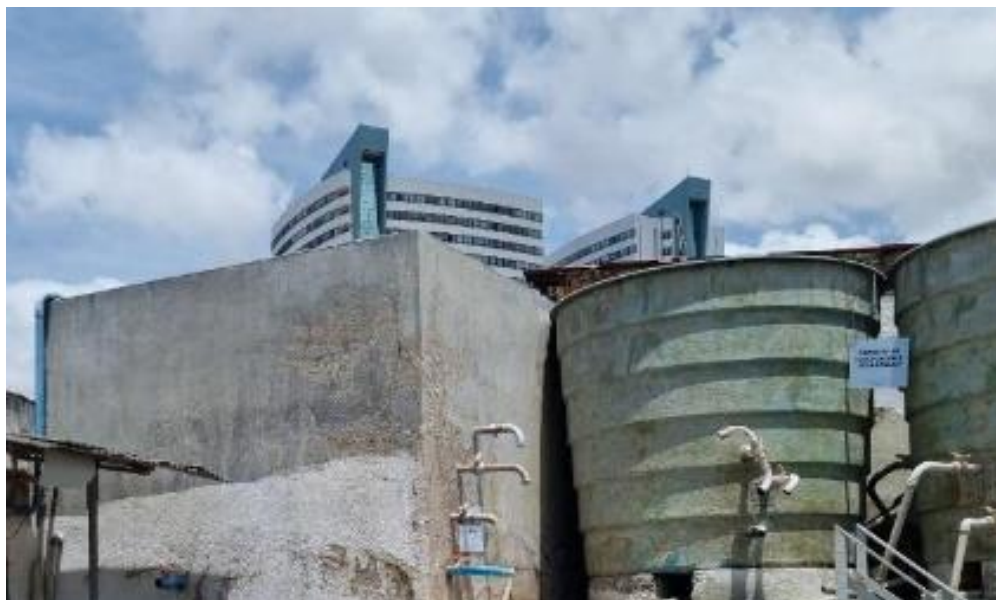
Figura 5: Tanque floclador da lavanderia parceira.
