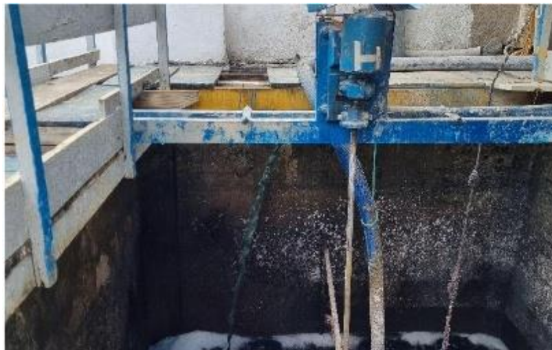
Figura 3: Estação elevatória de efluente bruto da lavanderia parceira.
