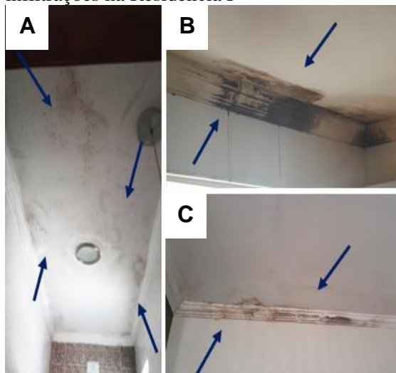
Figura 3: Manchas de mofo e resquícios de infiltrações na Residência F
