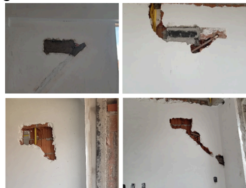
Figura 2: Retrabalhos no revestimento de gesso
