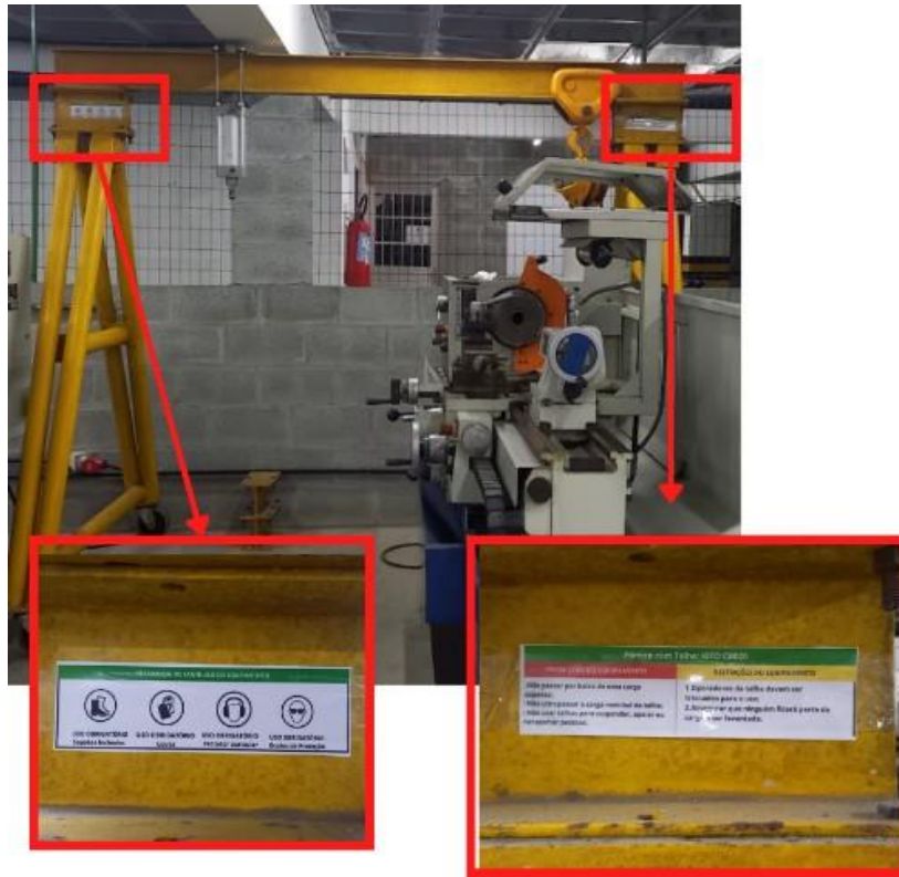
Figura 17- Pórtico com talha com placa de sinalização.
