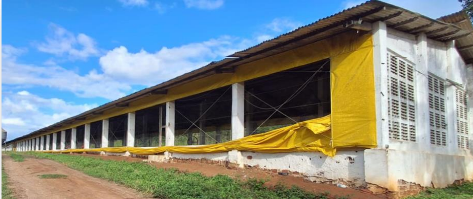
Figura 70. Galpão de pressão positiva (Fonte. Arquivo Pessoal)
