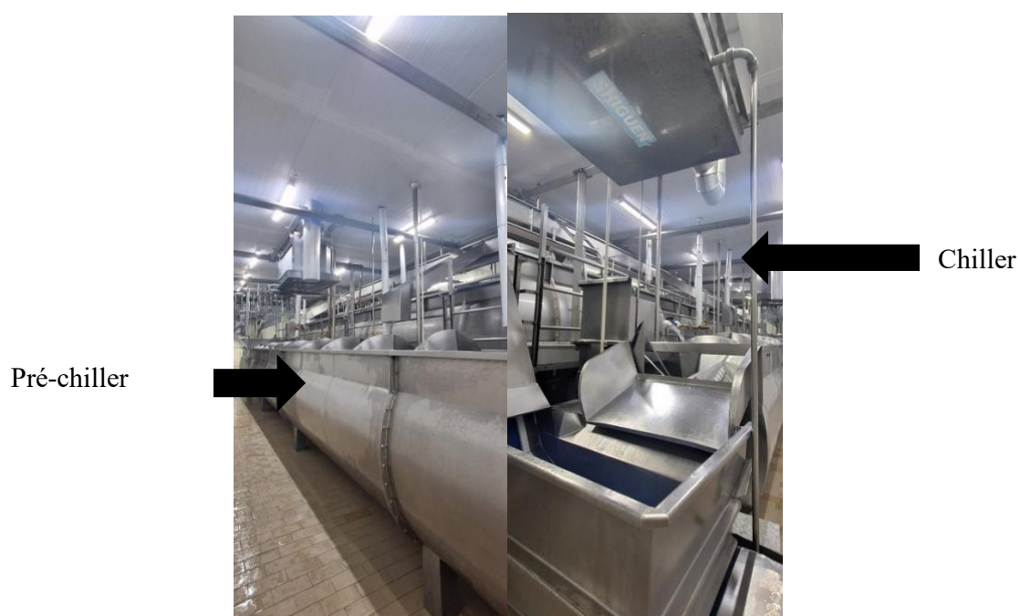
Figura 95. Pré-chiller e Chiller do abatedouro
