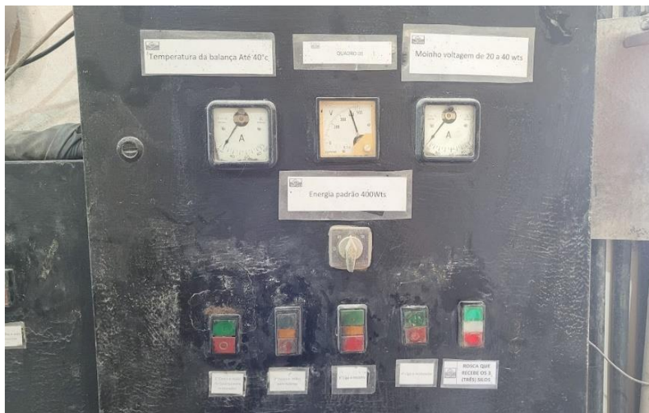
Figura 3. Quadro de controle dos elevadores, do moinho e do misturador da fábrica de ração
