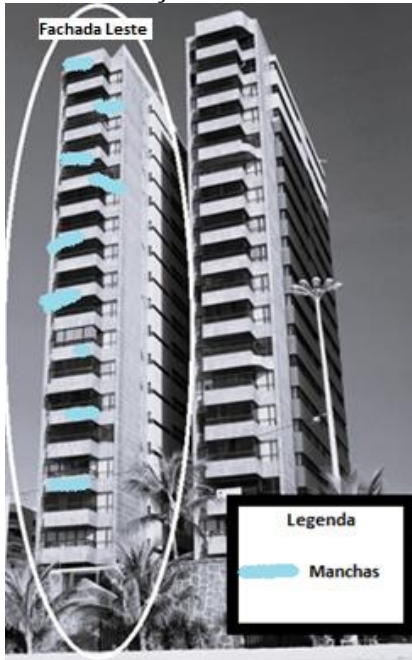
Figura 06: Mapa de danos ilustrativo das patologias encontradas na fachada leste do condomínio C, depois de 1 mês dos serviços de manutenção realizados.
