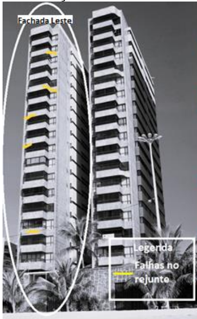
Figura 05: Mapa de danos ilustrativo das anomalias encontradas na fachada leste do condomínio C, antes dos serviços de manutenção.
