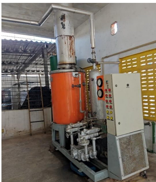
Figura 01 – Gerador de vapor utilizado no programa sopa amiga.
