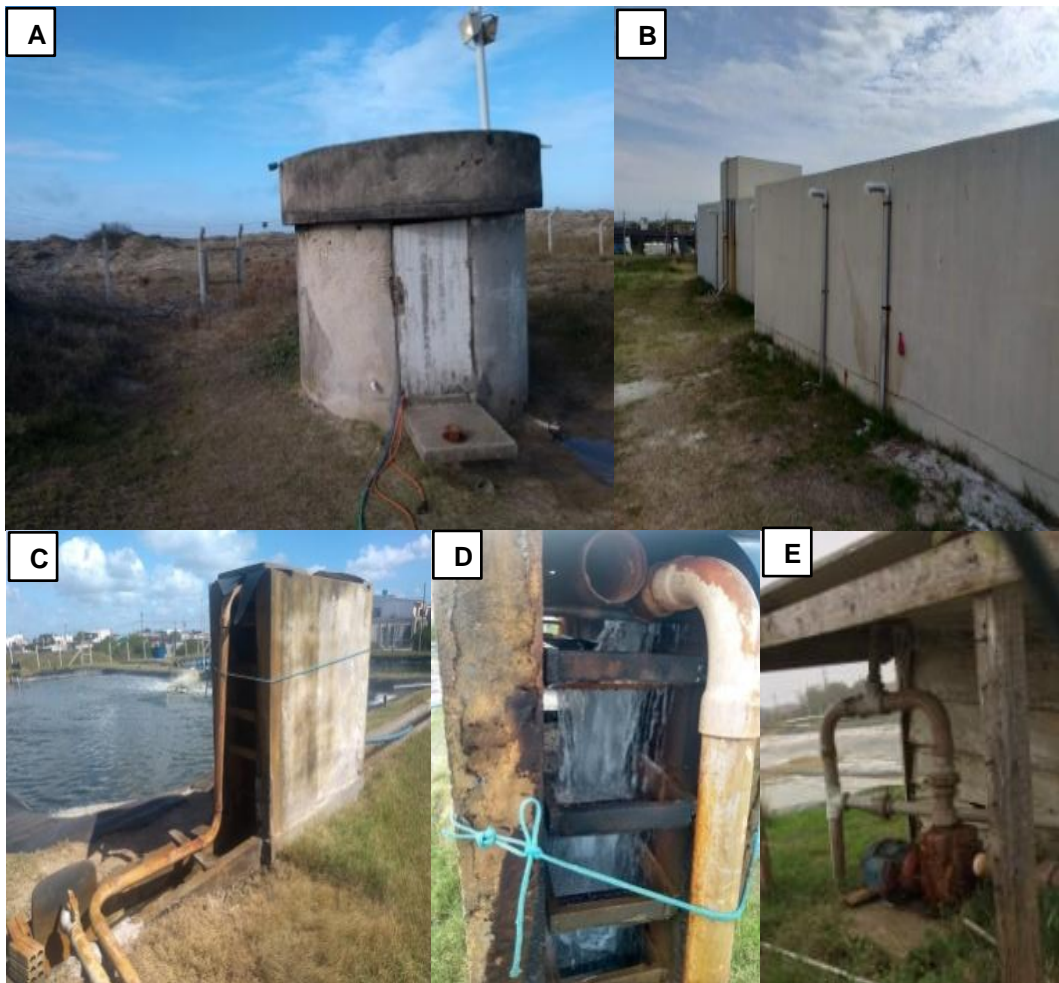
Figura 11 - Sistema de abastecimento. (A) Poço onde se encontra a bomba da praia; (B) Reservatório de água; (C) Desgaseficador, entradas de água, do mar e do solo, e calha central de distribuição; (D) Detalhe interno do desgaseficador e (E) Bomba hidráulica.
