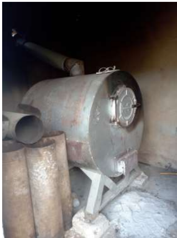
Figura 35. Debona de aquecimento
