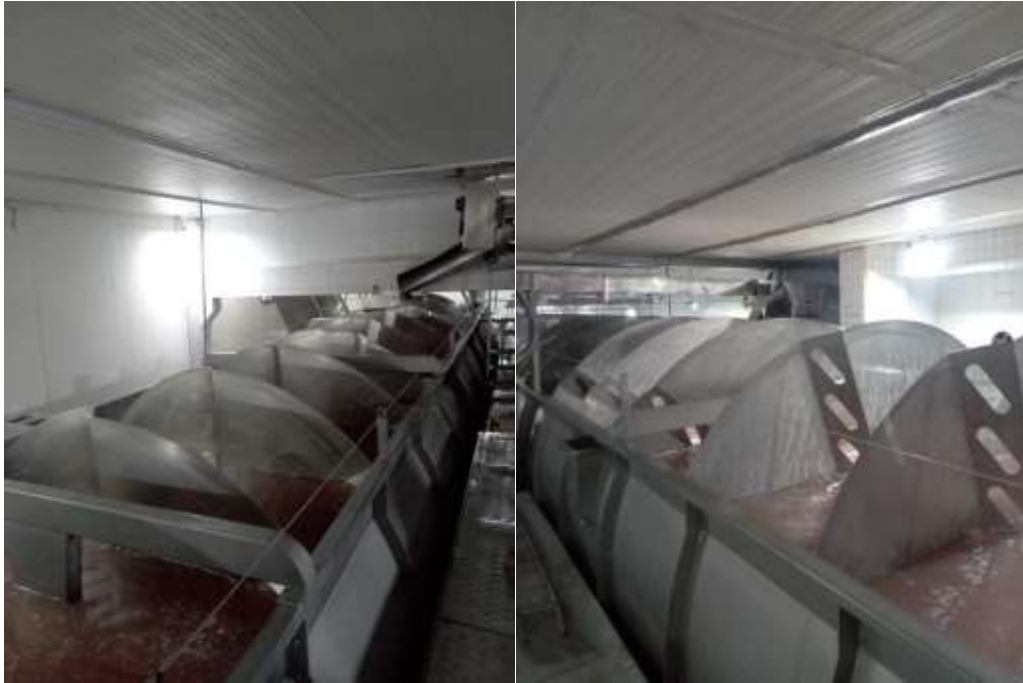
Figura 48. Pré-chiller e Chiller de resfriamento
