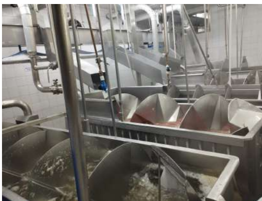
Figura 105. Mini-chiller de miúdos
