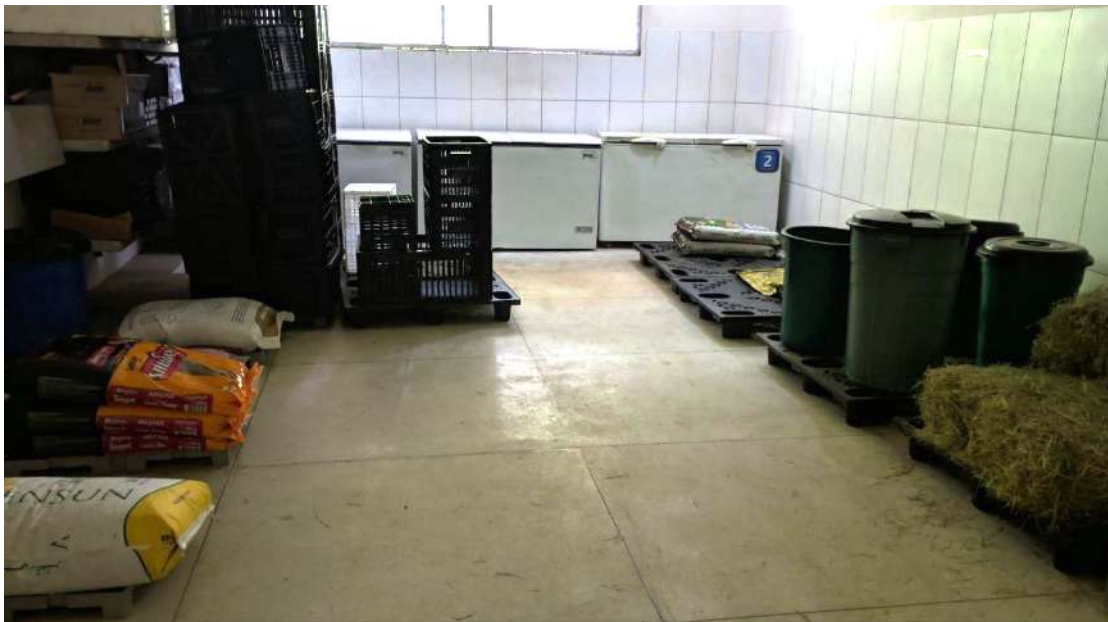
Figura 11. Depósito de armazenamento de ração (Fonte: Acervo pessoal).
