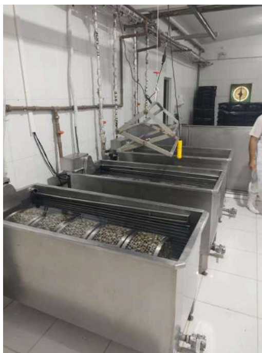
Figura 50. Tanque de resfriamento.
