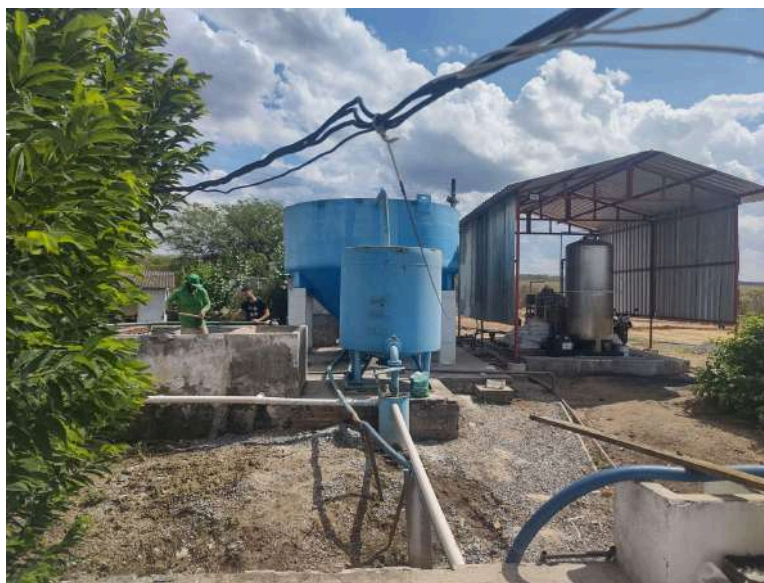
Figura 9. Estação de tratamento de água.
