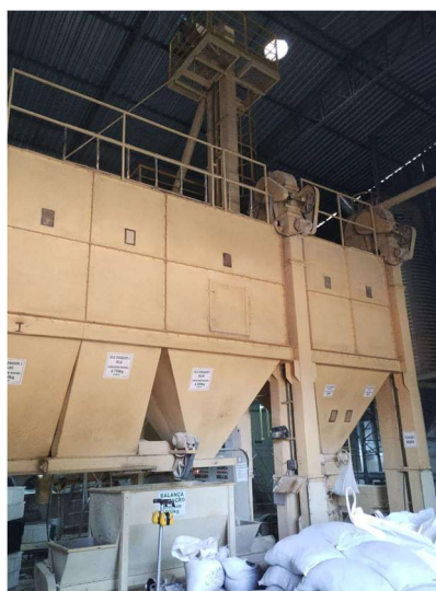
Figura 34: Silos dosadores e moinho.
