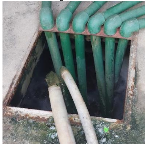
Figura 3 – Falhas estruturais no sistema de tratamento de água do setor de extrusão
