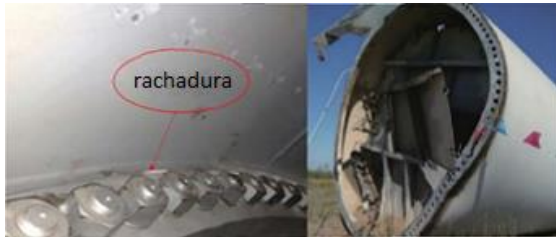
Figura 2 – Torre terrestre colapsada devido à fadiga.
