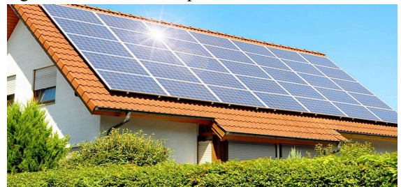
Figura 10: Telhado com painéis solares.
