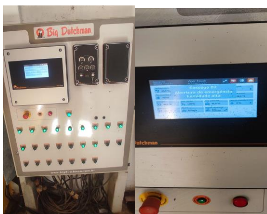
Figura 20: Painel de controle do galpão.
