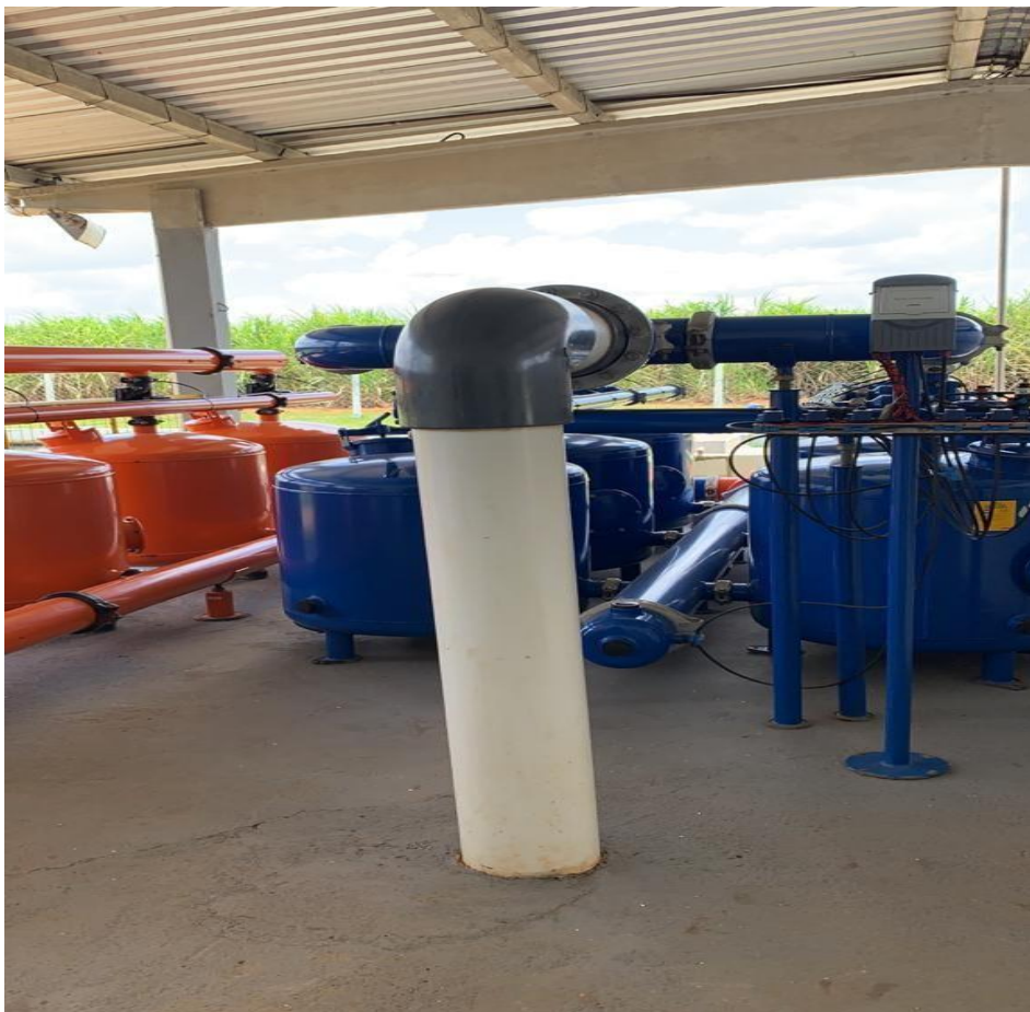
Figura 18: Tanques de areia do projeto de gotejamento
