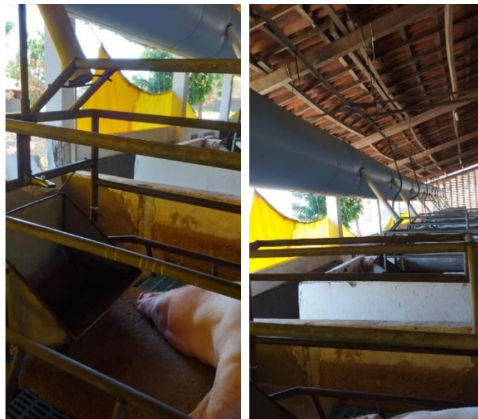
Figura 8. Sistema de ventilação adiabático localizado
