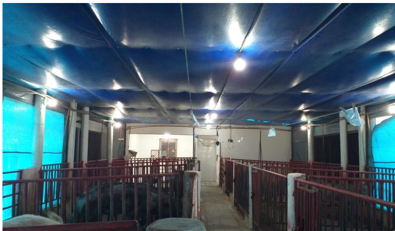
Figura 9. Galpão com sistema de resfriamento por pressão negativa
