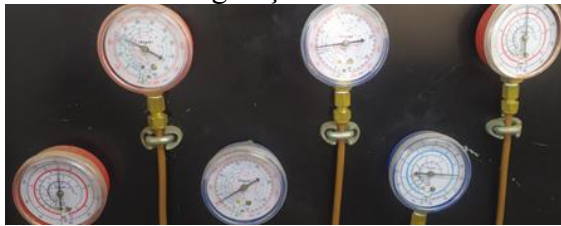
Figura 5 - Manômetros de pressão da bancada de refrigeração.
