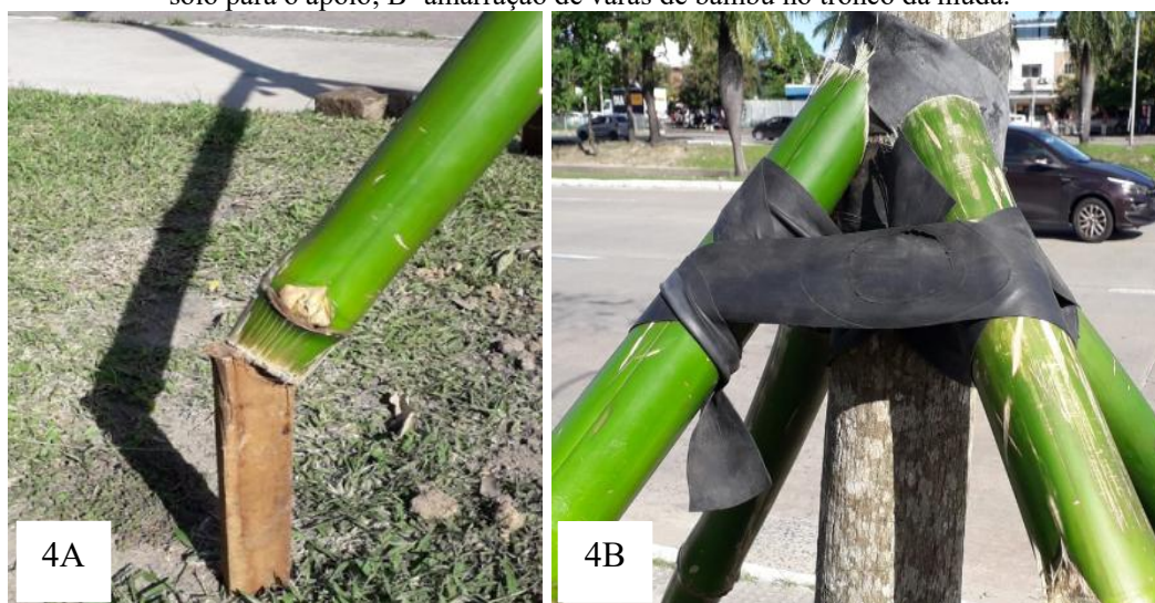
Figura 4 - Escoramento das mudas com padrão de diâmetro a altura do peito de 10 cm: A- estacas cravadas no solo para o apoio; B- amarração de varas de bambu no tronco da muda.
