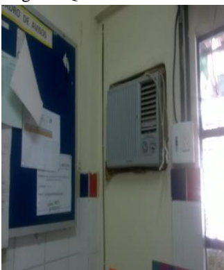
Fig. 7 - Quadro de aviso/ar condicionado
