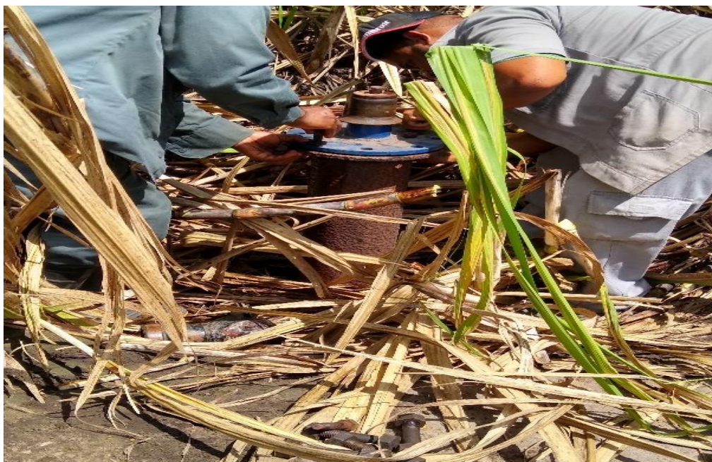
Figura 19: vazamento no hidrante e a sua manutenção/substituição da peça defeituosa.
