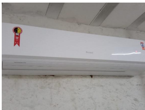
Figura 40 – Ar condicionado da sala de sementes Terra tecnologia Agrícola – Jabotão dos Guararapes
