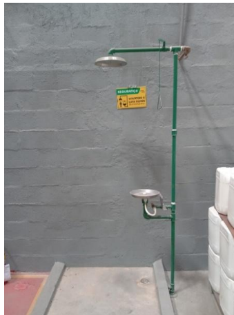
Figura 5 – Chuveiro de emergência e lava-olhos
