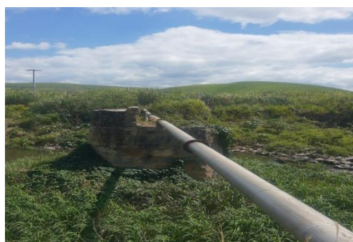
Figura 39: Tubulação onde a vinhaça é escoada.
