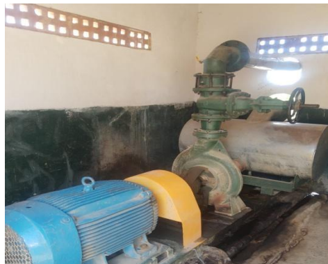
B. Eletrobombas fixas casa-de-bomba 2.
