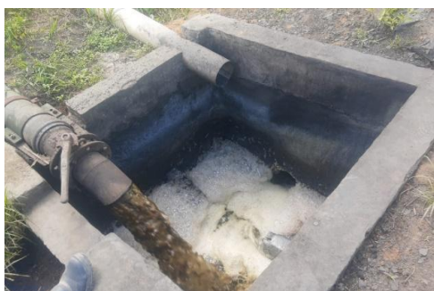
Figura 38: Caixa onde cai a vinhaça vinda do açude do geo.
