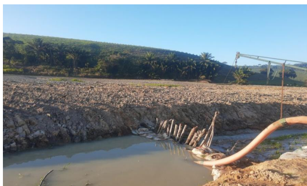
Figura 42. Sistema de tapagem.
