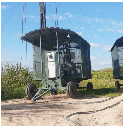
Figura 44 C. Transformador móvel.
