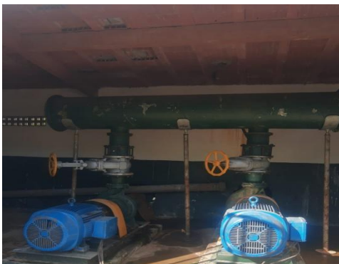
Figura 43. A. Eletrobombas fixas casa-de-bomba 1.
