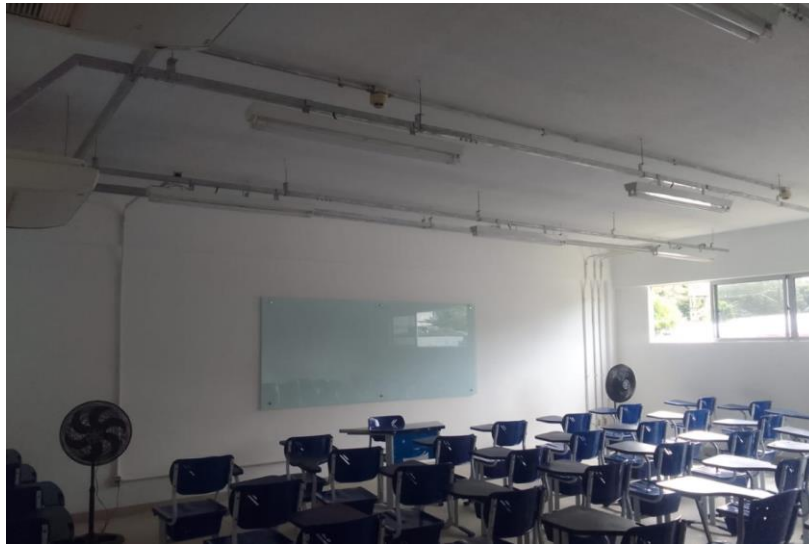
Figura 12. Sala de aula presente na edificação do Ceagri II com problemas de conforto térmico.
