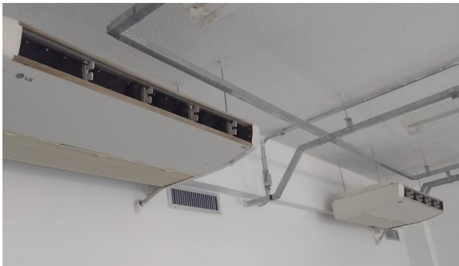
Figura 10. Exemplo de equipamentos de ar condicionado avariados presentes na edificação.
