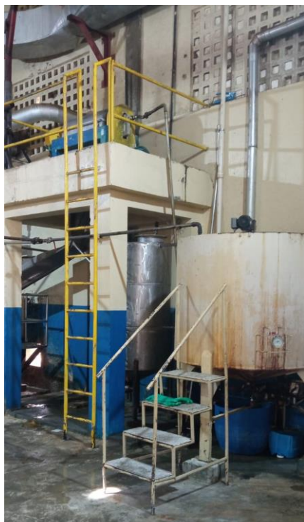
Figura 42. Tanques de filtragem
