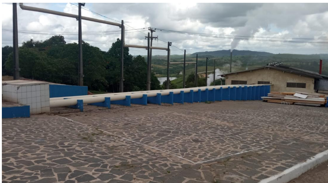
Figura 38. Tubulações de transporte de resíduos
