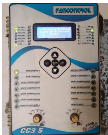
Figura 25 – Painel de controle automático em aviário de pressão negativa.
