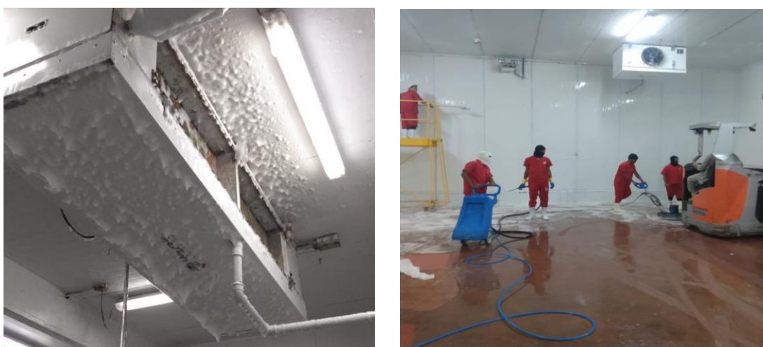
Figura 7 – Processo de higienização, salão da logística e evaporadores locais
