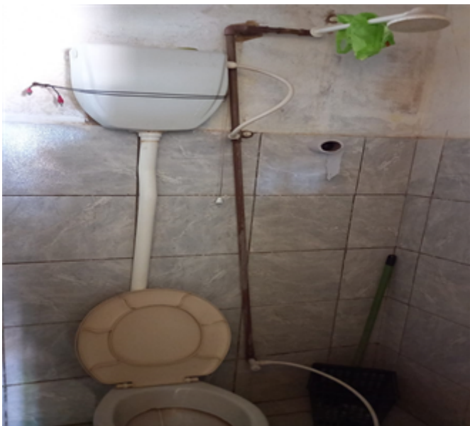
Figura 19. Banheiro para o público com a lixeira sem tampa e sem local adequado para papel higiênico e sem dispenser de toalha descartável.
