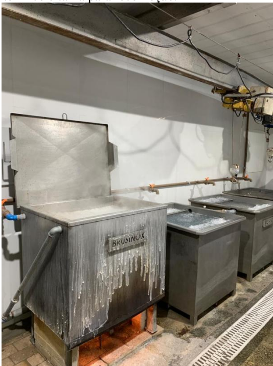
Figura 16. – Caldeirões, cuba para choque térmico e talha para locomoção.
