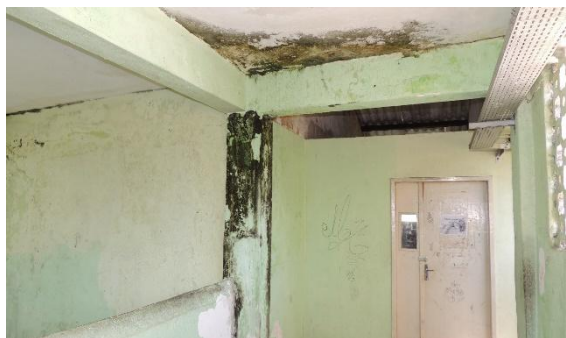
Foto 2: infiltração na parte interna do Campus São Lourenço.
