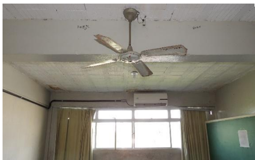
Foto 3: Ventilador do campus de São Lourenço
