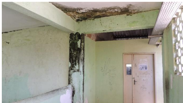
Figura 5. Bolor encontrado em diversos pontos da instituição.
