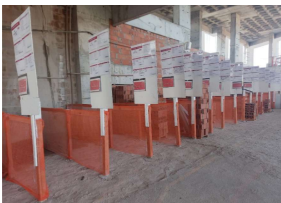
Figura 1: Central de Trinchos com identificação dos kit's.
