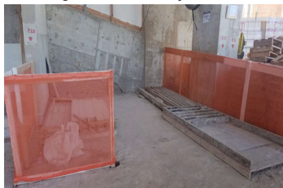
Figura 2: Central de produção das vergas e contra vergas com as suas respectivas formas.
