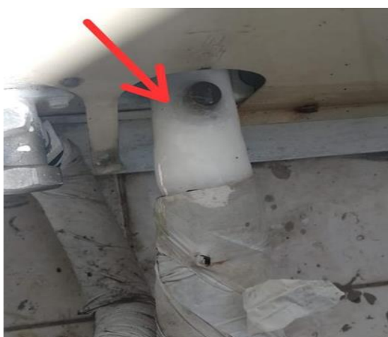
Figura 4: Congelamento da tubulação da unidade condensadora indicando possível vazamento
