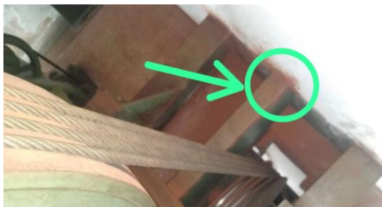
Figura 14: Partículas soltas do cabo de içamento
