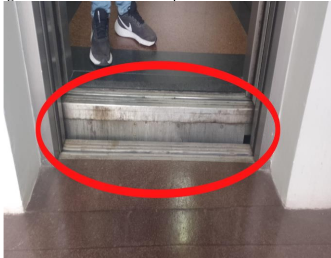
Figura 2: Desnivelamento entre pavimento e cabina do elevador
