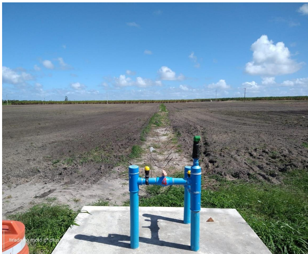
Figura 09: Cavalete/Válvula de acionamento do setor 04.
