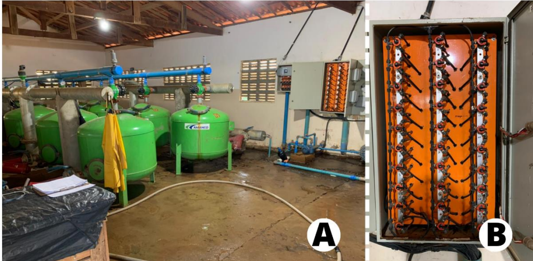
Figura 15. Vista da casa de filtros (A), quadro de válvulas para controle de irrigação em cada área (B). Fonte: Autora (2022).
