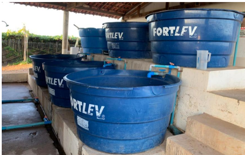
Figura 17. Tanques de diluição dos fertilizantes. Fonte: Autora (2022).
