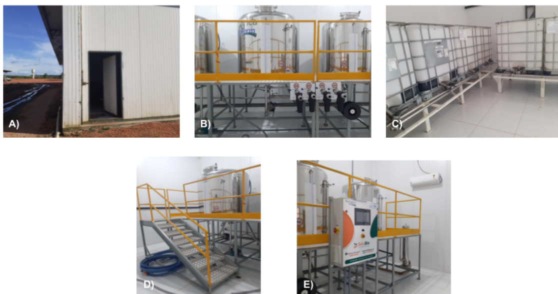
Figura 3: Estrutura da Biofábrica. Imagem A) Biofábrica da fazenda Estrela, imagem B) Tanques de multiplicação, imagem C) Bags de estoque, imagem D) Escada de acesso aos tanques de multiplicação, imagem E) Ambiente climatizado com painel de controle. Fonte: Arquivo pessoal da autora, 2022.
