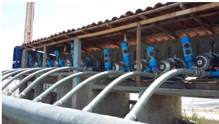
Figura 15: Bateria de sopradores.
