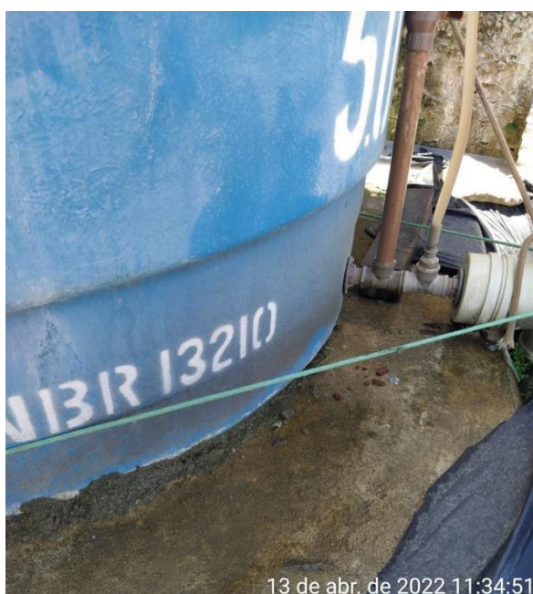
Figura 06: Vazamento da instalação de caixa d'água.
