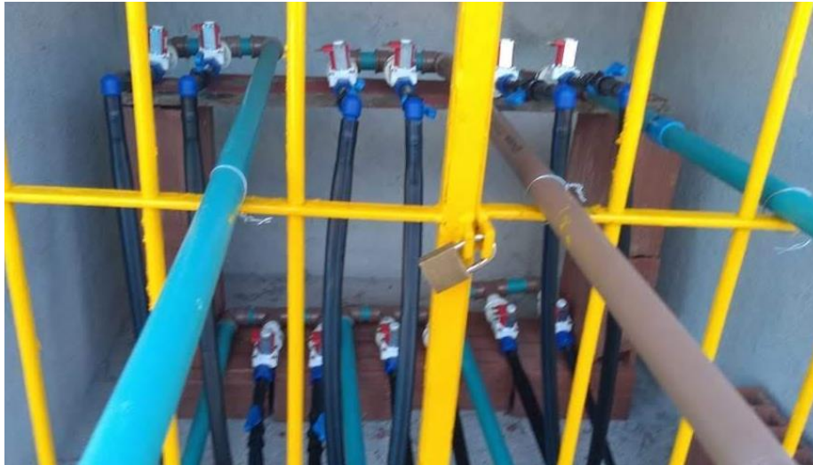
Figura 8. Distribuição das válvulas solenoides em abrigo de alvenaria.
