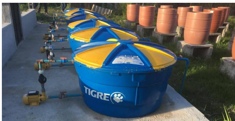
Figura 10. Reservatórios para armazenamento de solução salobra e bombas para irrigação.
