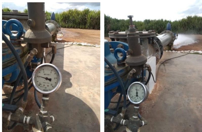
Figura 32. Manómetros que marcam a pressão do sistema.
