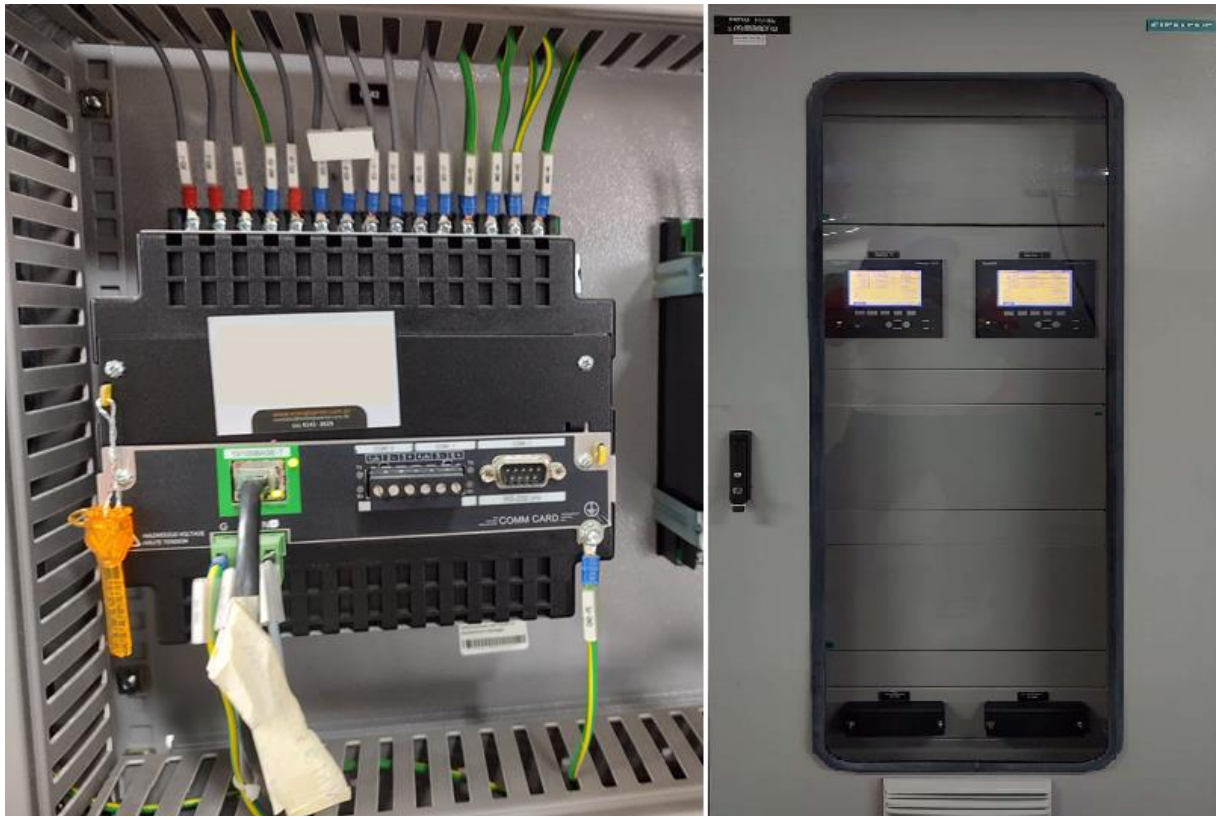
Figura 9 - Conexões reais do medidor / painel de medição.
