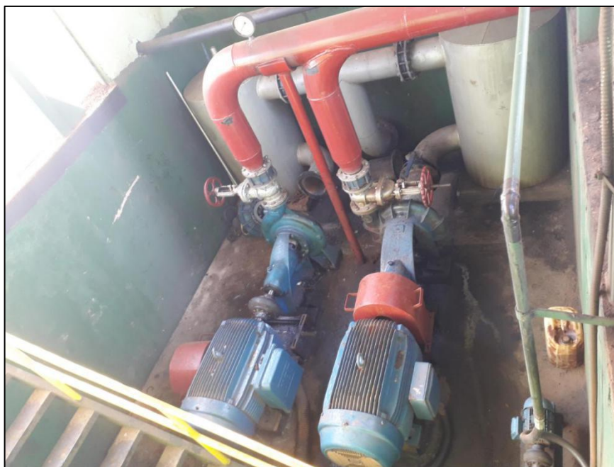
Figura 17. Bombas em adutora de irrigação. Fazenda Bonito I. Serranópolis-GO
